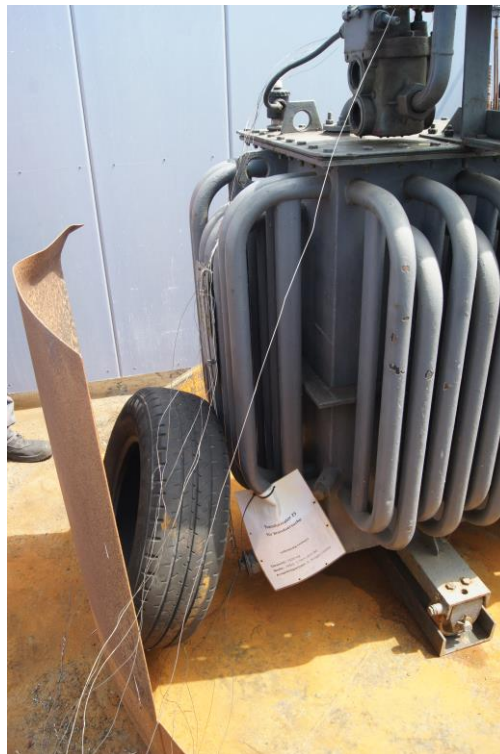
Abbildung 3: Rückbrandsituation. Ein Reifen befindet sich hinter dem Trafo. Der Trafo steht in der Brandwanne mit dem Prallblech. Bild: Berliner Feuerwehr. 2017.
