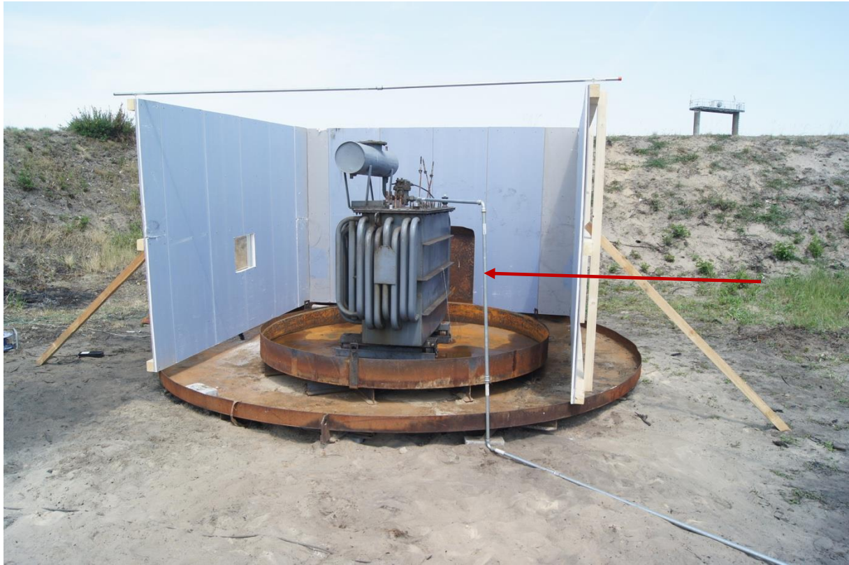
Abbildung 1: Transformator mit dem Ausdehnungsbehälter an der Oberseite in der Brandwanne. Die Brandwanne ist durch eine Auffangwanne abgesichert. Die Rohrkonstruktion (roter Pfeil) diente zur Simulation des austretenden Transformatoröls. Bild: Berliner Feuerwehr, 2017.
